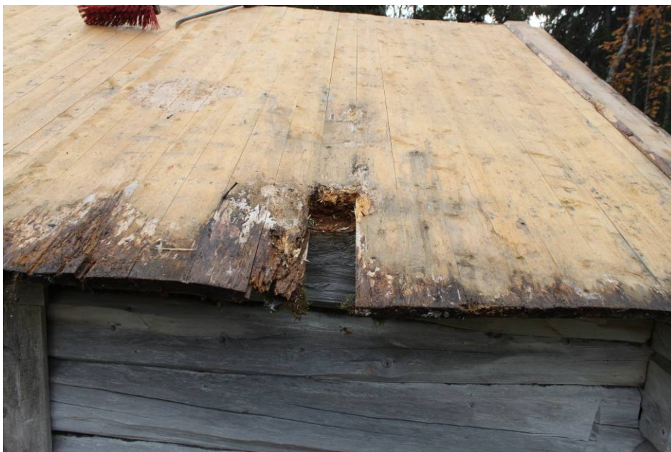
Rotning med rötskador vid takfoten
