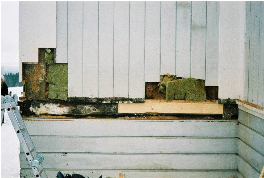
Bild 3. Långhusets NO-vägg under pågående restaurering. Isoleringen har satts dit för att hindra att sågspånet faller ut. Spikregel är ilagad och den rötskadade panelen avkapad. På bilden syns tydligt att knutlådan består av två stående bräder (neg nr 07M003/07).
