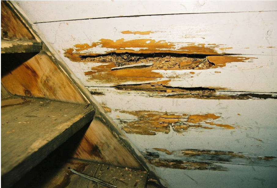
Bild 13. Skadad panel på väggen i tornet bakom trappan på våning 3 i tornet (neg nr 07M003/20).
