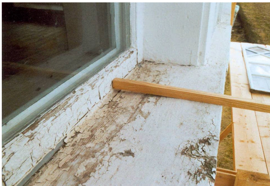
Bild 9. Karmunderstycket på sakristians fönster lutade inåt vilket gjorde att vatten trängde in under fönstren (foto Stig Nilsson).
