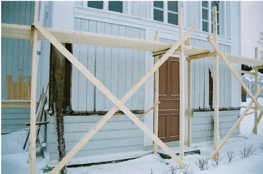
Bild 5. Skadorna på sakristians norra vägg var omfattande (neg nr 07M020/04).
