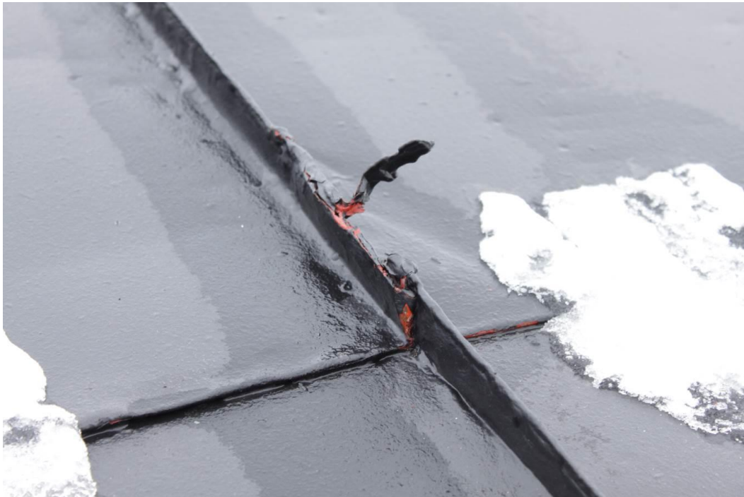
Ståndfalserna har spruckit på en del ställen. Vatten har kommit in i falsen och den har under åren rostet sönder. Under den svarta färgen syns en orange grundfärg/rostskyddsfärg.
