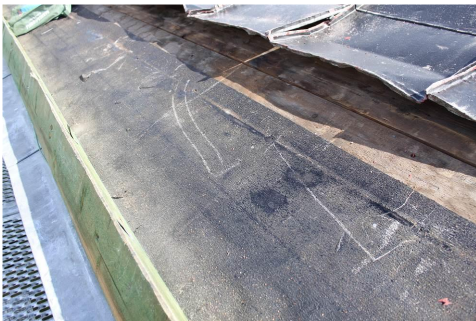
Plåten vid takfoten och fotrännan har demonterats. Det visade sig att det låg papp under denna, takfortsvirket hade en grön kulör, men var inte tryckimpregnerad.
