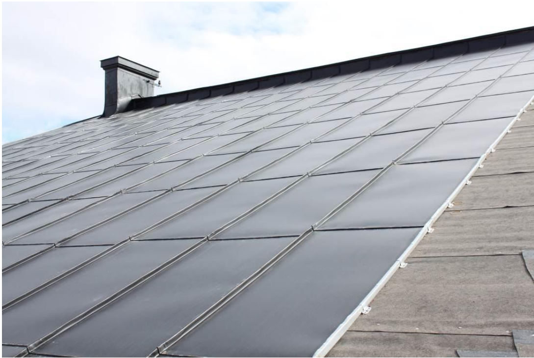
Äldre plåttäckning på skorstenar vid taknockens ändar behålls, nedre delar byts ut. I övrigt visar bilden den nya plåttäckningen.
