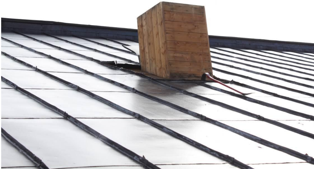
Ventilationshuv som demonteras. Taket är igenbyggt undertill och den hade enligt Rogers plåt inte längre någon funktion. Den hade heller ingen betydelse för takets estetiska uttryck.
