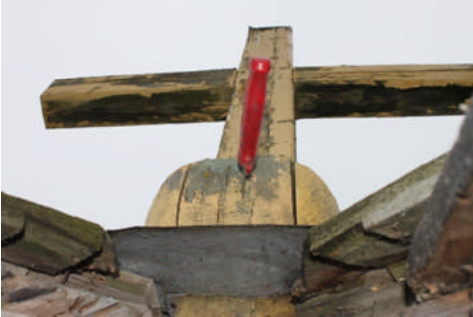
Bild 1: Korsglobens trä var i dåligt skick och byttes mot en nytillverkad.
