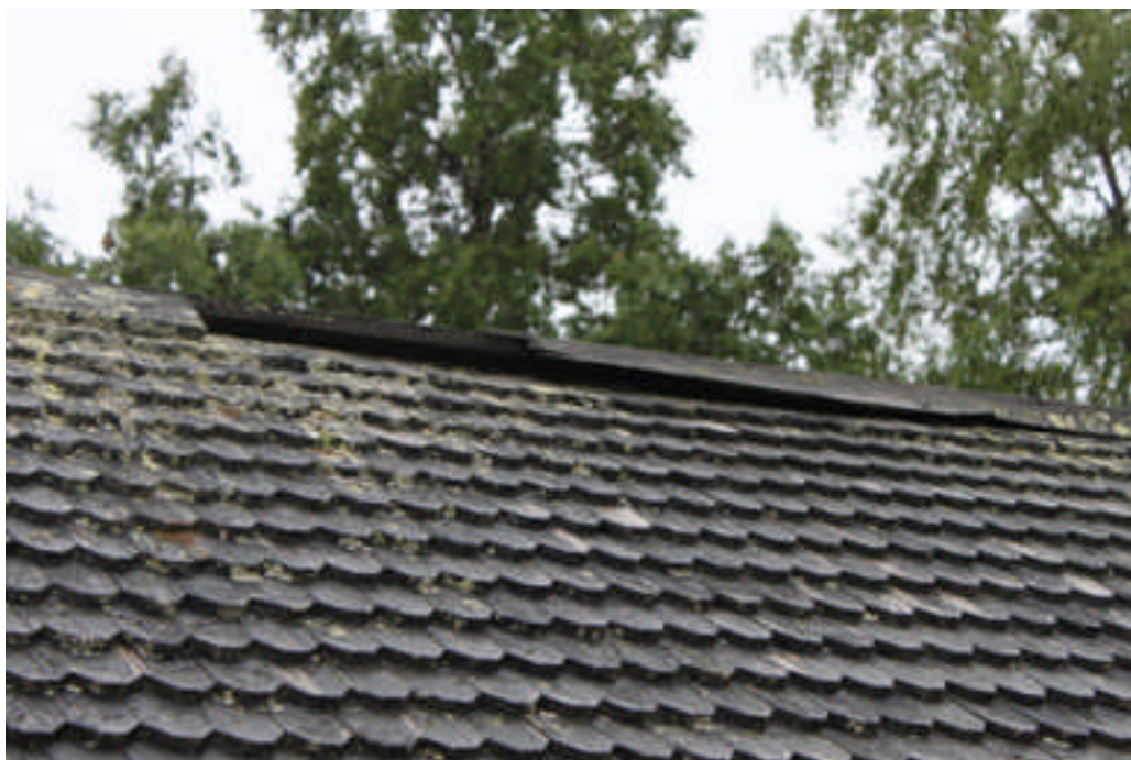
Bild 6: Flera av åsbrädorna var i dåligt skick och byttes ut.
