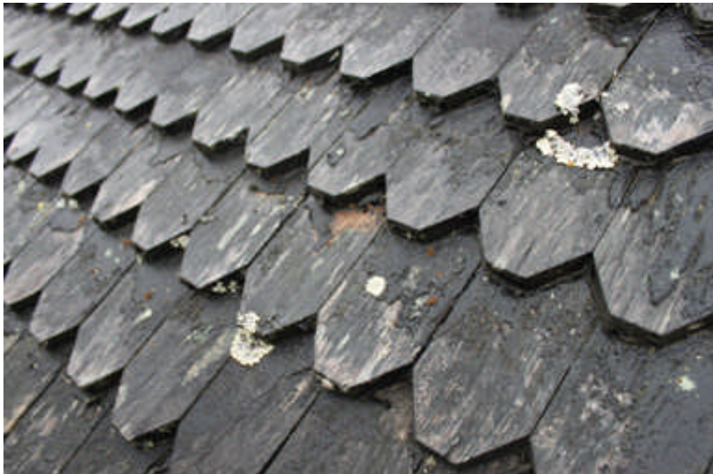
Bild 5: Rester efter kreosot och algpåväxt syns på takspånen.
