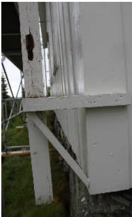
Bild 8: Stuprör innan bytet.
