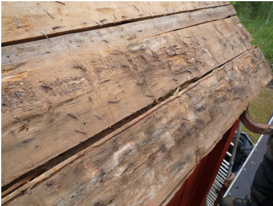
Flera rotbrädor var i dåligt skick och byttes därför ut (digital bild nr 1000973).
