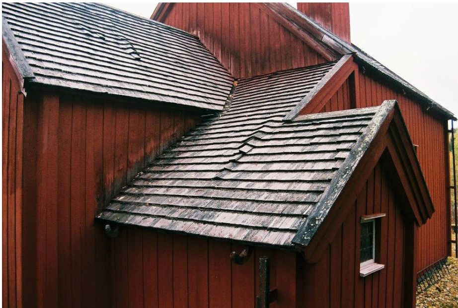
Takspånen hade rest sig på flera ställen. Här vid absidens norra och sakristians östra takfall (bild nr 08m47/05).
