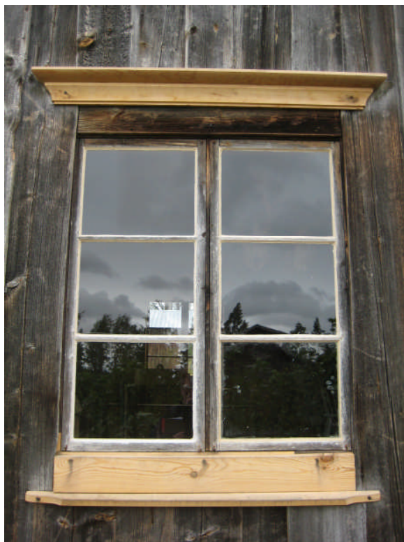
Fönster på C-vägg, utbytt list, dropplist och kornisch
