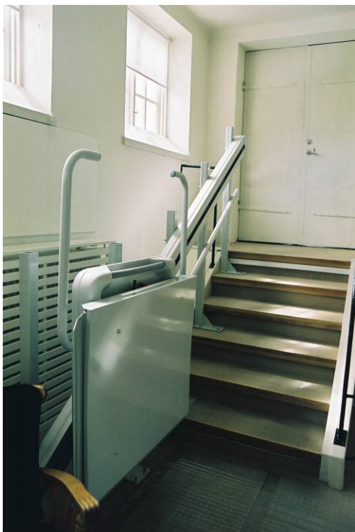
Trapphissen mellan utställningsrum 302 och skulpturhallen 304. Jlm 05m212/3
