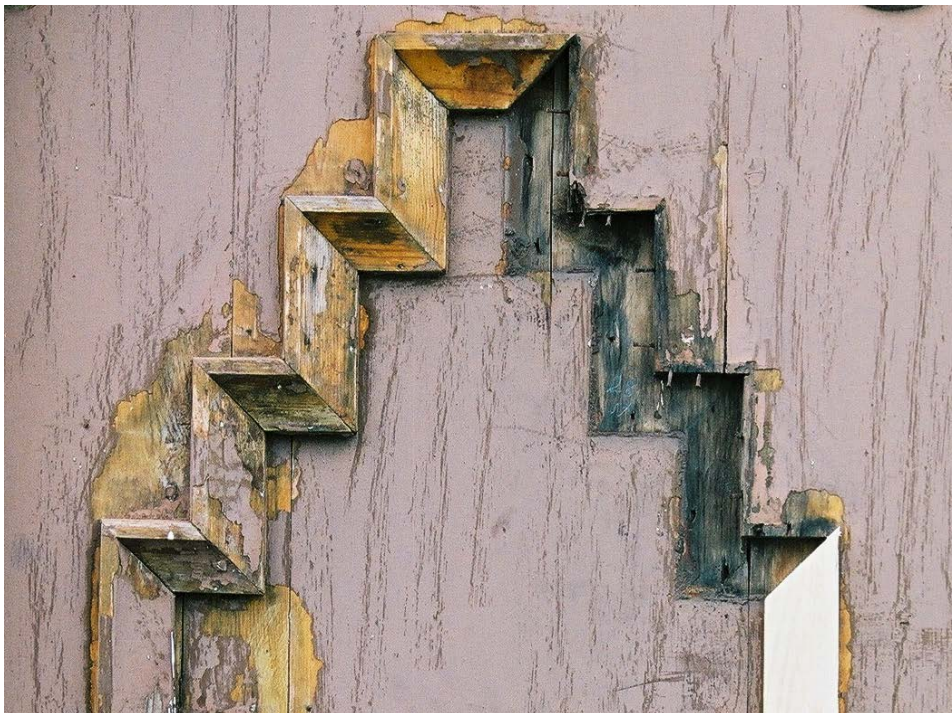
Figur 2 Under den bruna alkydoljefärgen upptäcktes under restaureringen att dörrbladen tidigare varit målade med oljefärg i guldocker. Bilden visar skadade lister på Huvudentrén åt väster.
