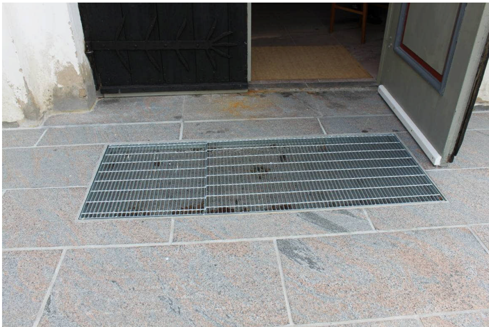
Bild 23: Pardörr med nya lister. Vid efterbesiktningen 2011-10-03 var listerna ännu inte målade i dörrens rätta kulör. Skrapgallret var felkonstruerat. Bristerna skulle åtgärdas före 2011-11-24
