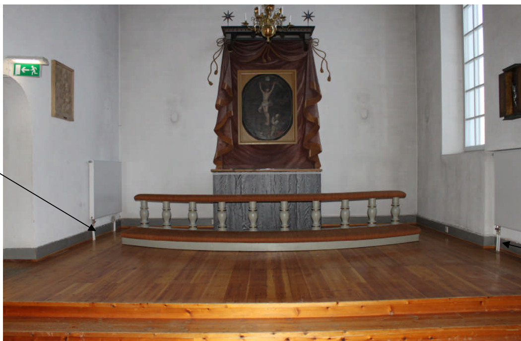
Bild 10: Nya radiatorer i koret. Enligt efterbesiktningen 2011-10-03 skulle ledningarna målas in i samma kulör som sockeln. Detta skulle åtgärdas senast 2011-11-24
