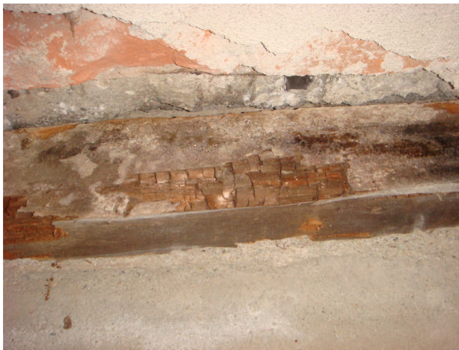
Bild 16: Upprötad syll i vapenhuset
