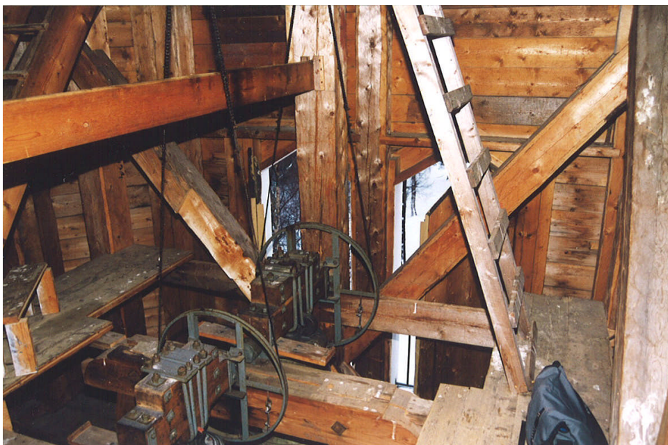
Bild 3. Bilden är tagen från samma ställe som bild 2. De två yttersta klockorna mot väster syns på bilden och stegen upp till kyrkklockornas elmotorer. Foto 02m9
