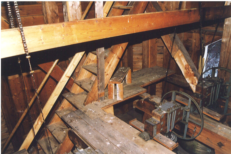
Bild 2. Bilden är tagen från golvnivån ovanpå klockbocken före åtgärd. I bakgrunden syns trappan upp till lanterninen. Foto 02m9
