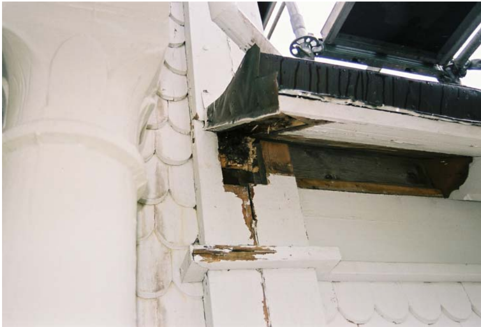
Bild 10. Taksparrarna både till höger och vänster om entrén var helt rötade och fick skarvas. Här syns resterna efter den rötskadade taksparren till höger (neg nr 06M41/21).
