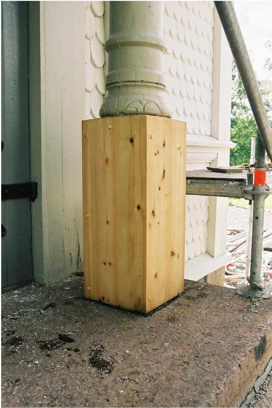
Bild 8. Samma låda efter lagning (neg nr 06M087/05).
