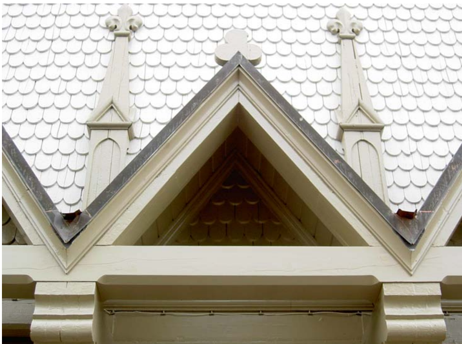
Bild 16. De nya vattenutkastarna mellan takfallen (digital bild pict 6533).
