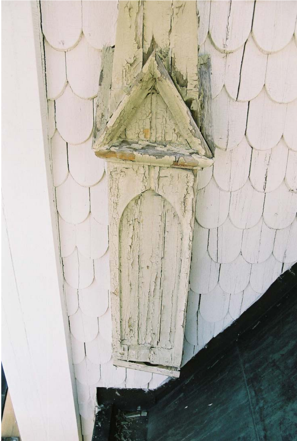
Bild 9. En av fasaddekorationerna på tornets västra fasad som var i stort behov av restaurering. Dessa var spikade mot fasaden (neg nr 06M29/27).
