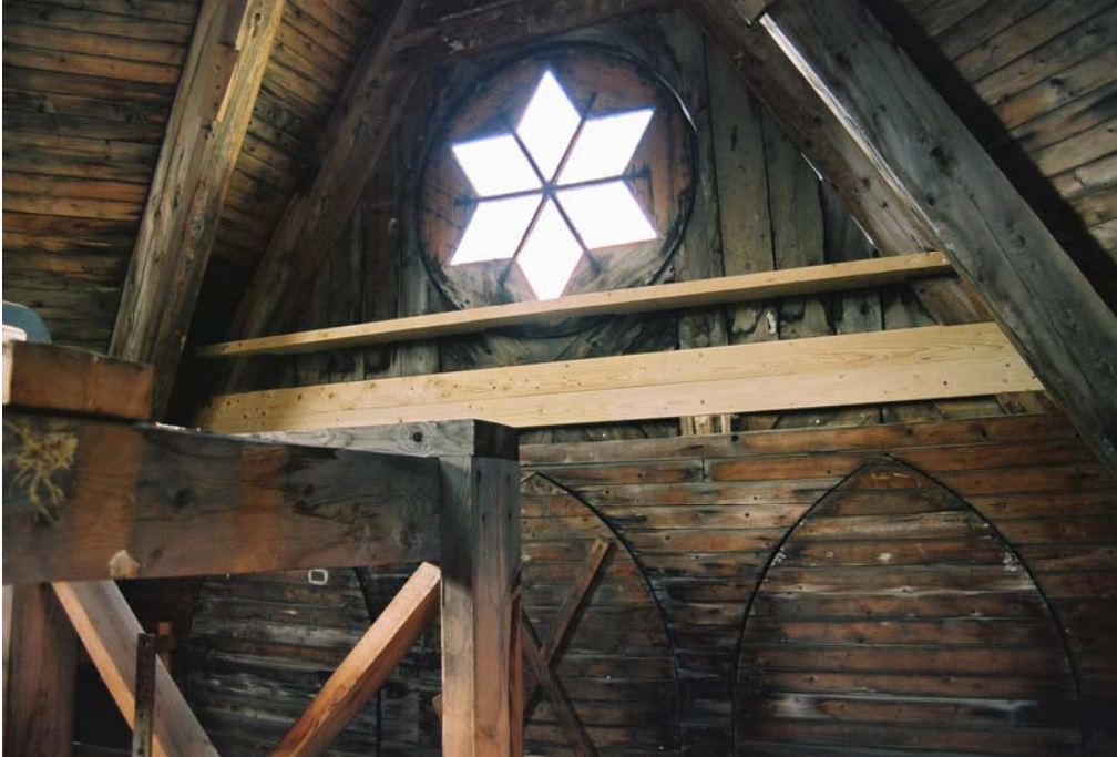
Bild 6. Lagningen av bjälken och förstärkningen ovanför ljudluckorna inuti tornet (neg nr 06M071/33).
