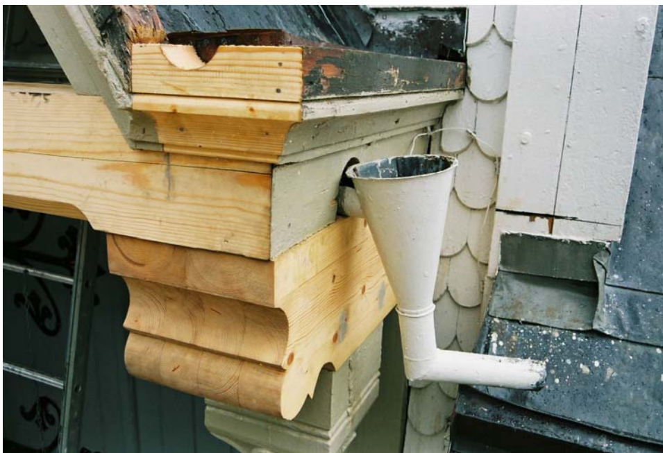
Bild 14. Lagningarna längst till höger ovanför entrén med den nygjorda konsolen (neg nr 08M019/36).
