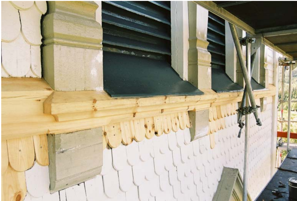
Bild 4. Lagningar på tornets västra fasad i höjd med klockvåningen. Bjälken under ljudluckorna byttes samt listverket utanpå bjälken. Plättäckningen under ljudluckorna sattes tillbaka (neg nr 06M087/23).
