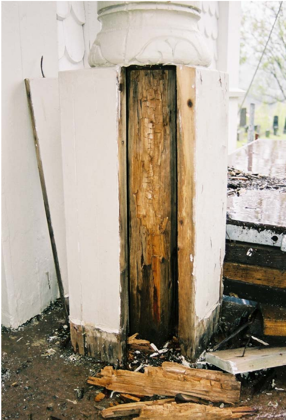
Bild 7. Den södra rötskadade pelaren. Fyrskärningen innanför de stående brädorna var helt upprötad (neg nr 06M041/19).
