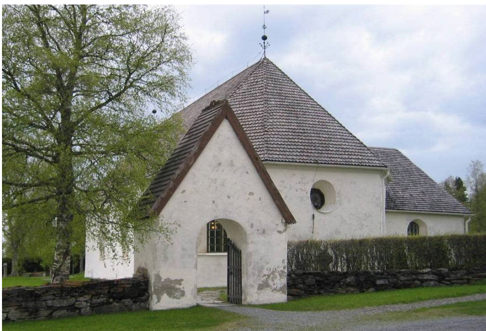
Bild 1. Bilden är tagen från öster och visar exteriören innan restaureringen. Skadorna i putsen syns tydligt på stigporten. Kyrkan putsades senast om 1973.
