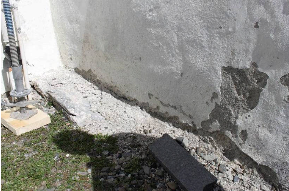
Bild 7. Putsskador förekom längs sockeln.
