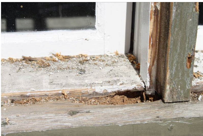
Bild 15. Skador i karm och mittpost.
