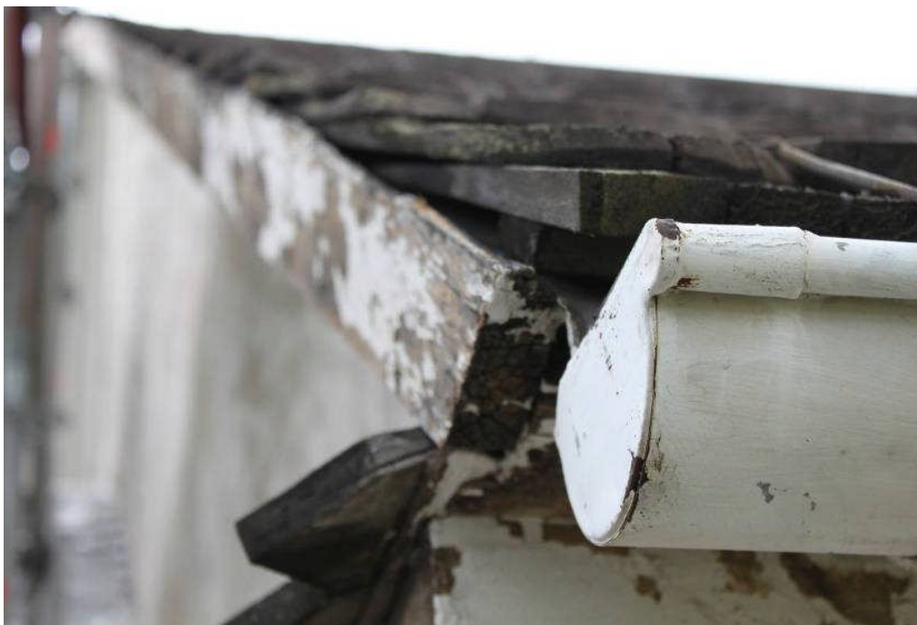
Bild 8. Färg flagade på trädetaljer. Här ses vindskivor som var i behov av målningsarbete.
