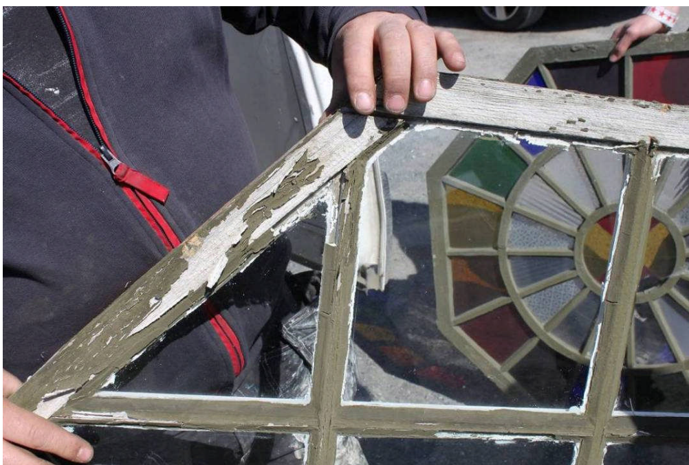
Bild 14. Vapenhusets fönster ovanför porten, färg flagnar.
