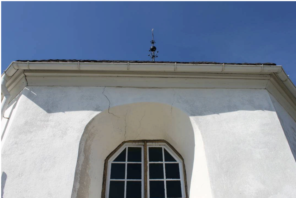
Bild 6. Sprickor förekom i fönstervalven innan restaureringen, här i koret.
