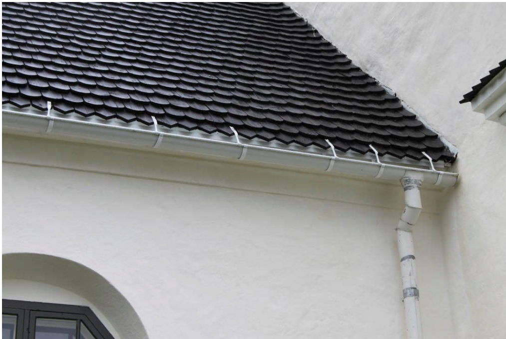
Bild 3. Hängränna nya fästen på vapenhuset syntes tydligt vid slutbesiktningen. Dessa målades sedan mörka längst upp och vita längst ner, varför de numera inte framträder lika tydligt.
