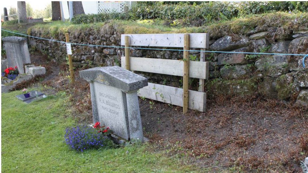
Tillfälliga trästaket hade satts upp för att förhindra att muren rasade.
