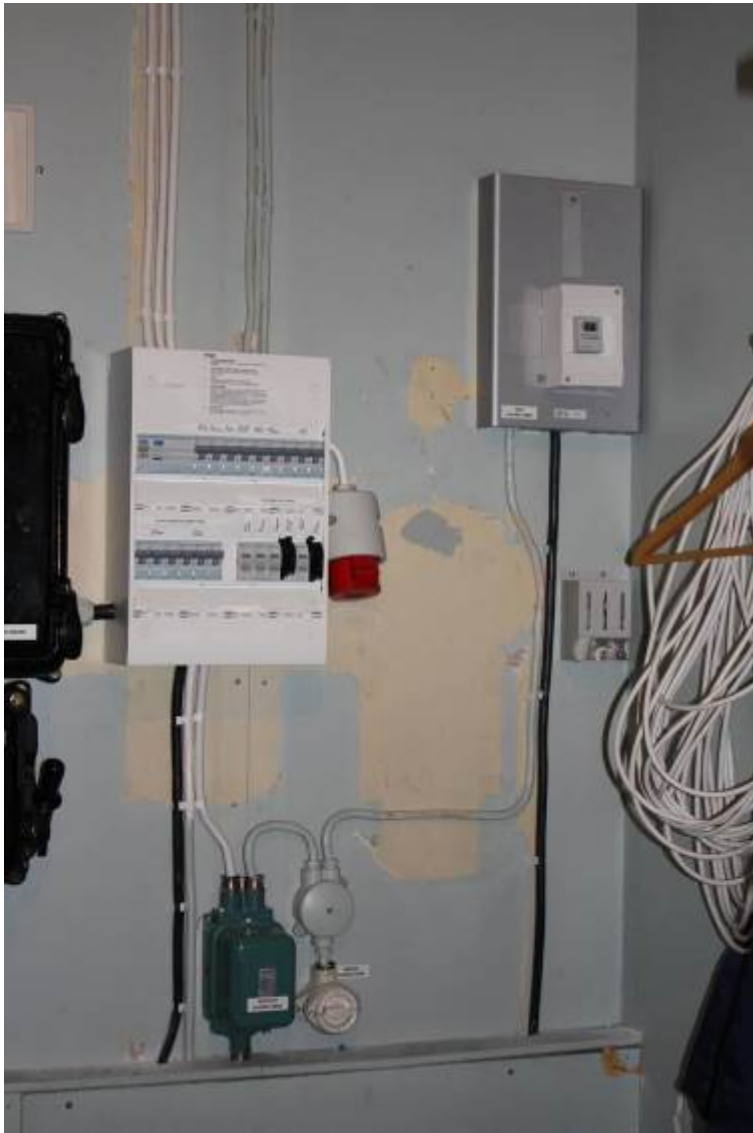
Ledningscentralen med nya elkablar, dessa behövde enligt Länsstyrelsens beslut inte målas in. IMG_032 Foto: Olof Edin
