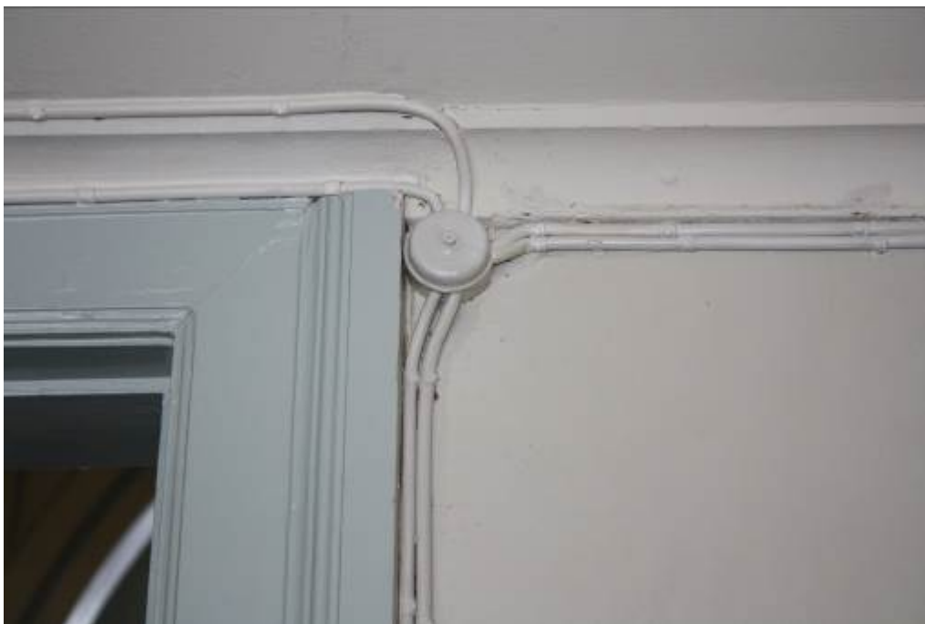
Kablar och kopplingsdosor har målats in för att passa bakomvarande färg. IMG_057 Foto:Olof Edin
