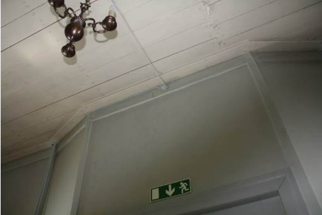
Vid den norra och södra ingången är nya kablar dragna till armaturen i taket. IMG_068 Foto: Olof Edin
