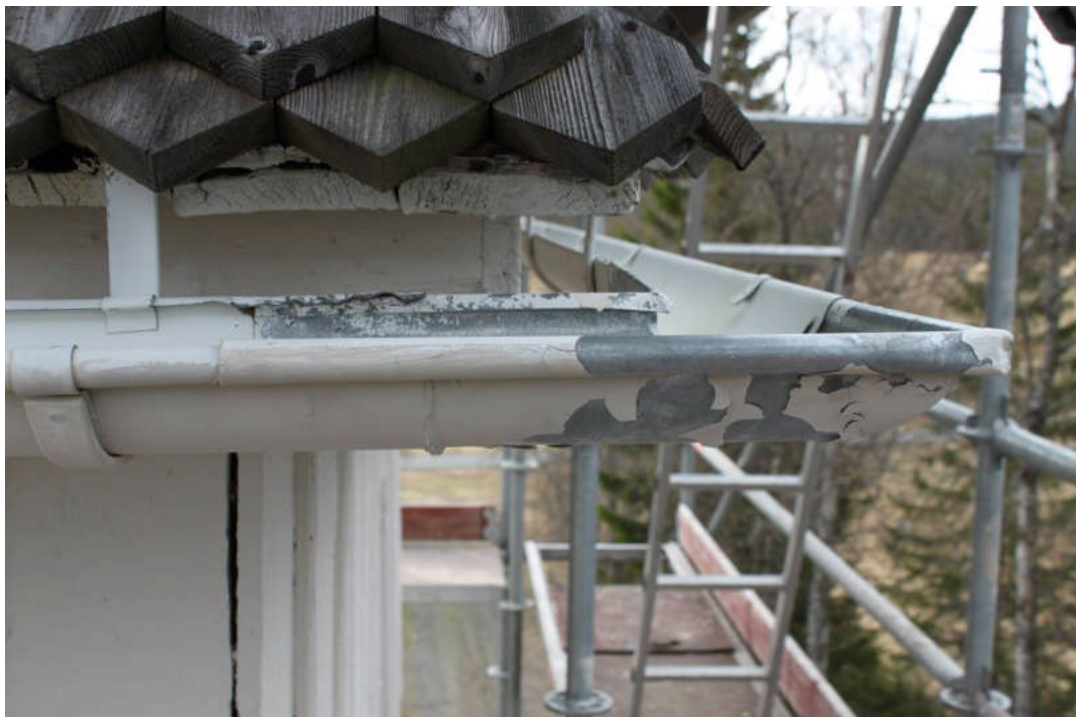
Hängrännor innan åtgärder.
