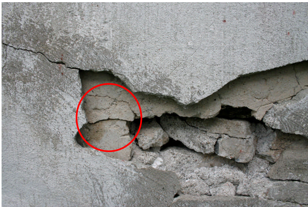
Bild 14. På insidan av norra bogårdsmuren togs ett prov (nr 2) från fogbruk som låg löst i murverket. Ytterligare ett prov (nr 1) togs på den yttersta gråa putsen med vit kalkfärg. Detta lager syns tydligt på bilden liksom den underliggande gulaktiga äldre putsen (i den röda ringen). Foto Christina Persson 2009-09-02
