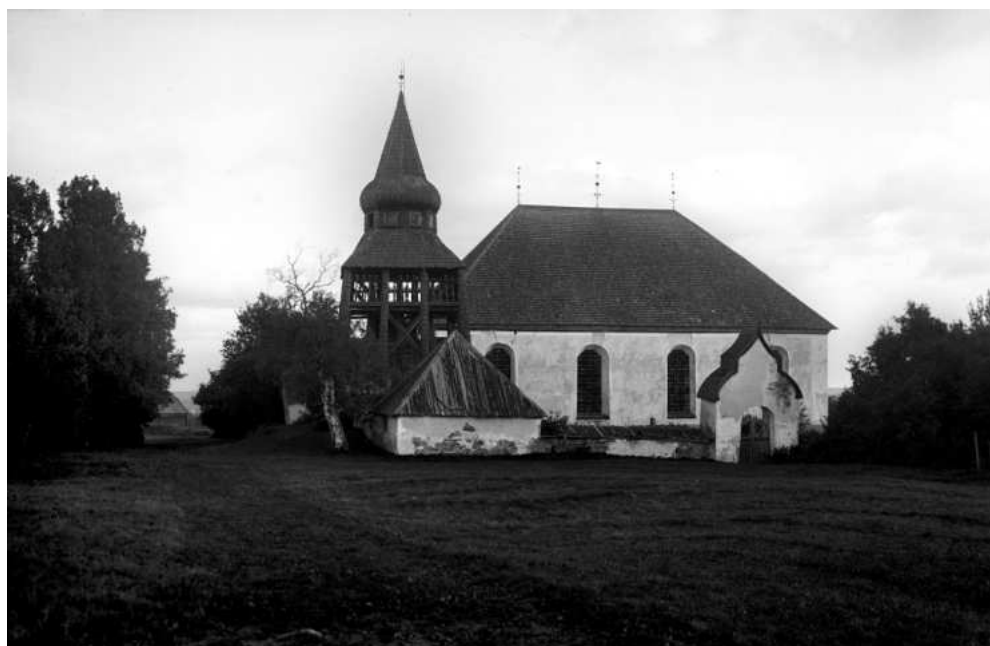
Bild 1. Erik Festin tog denna bild på 1920-talet. Det syns skador i putsen på södra stegporten, på bogårdsmuren mellan stegporten och bårhuset, på bårhuset och mellan taket och fönsternischerna på kyrkan. Jamtli bildarkiv C1224
