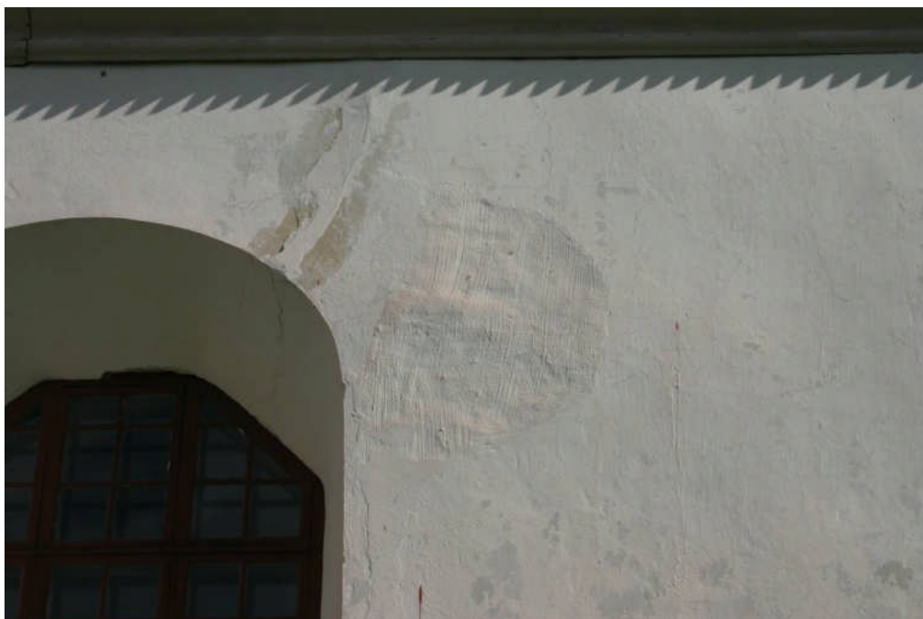
Bild 19. Spricka mellan fönster och takfot på södra fasaden. Liknande sprickor finns på flera fönster. Foto Christina Persson 2009-09-02
