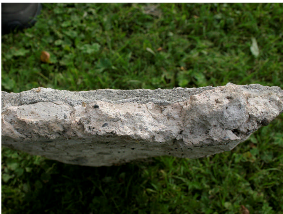
Bild 15. En av de lösa bitarna puts på norra bogårdsmuren. Det gulaktiga lagret är den äldsta putsen och utanpå ligger här ett lager modern grå kalkputs. Foto Christina Persson 2009-09-02
