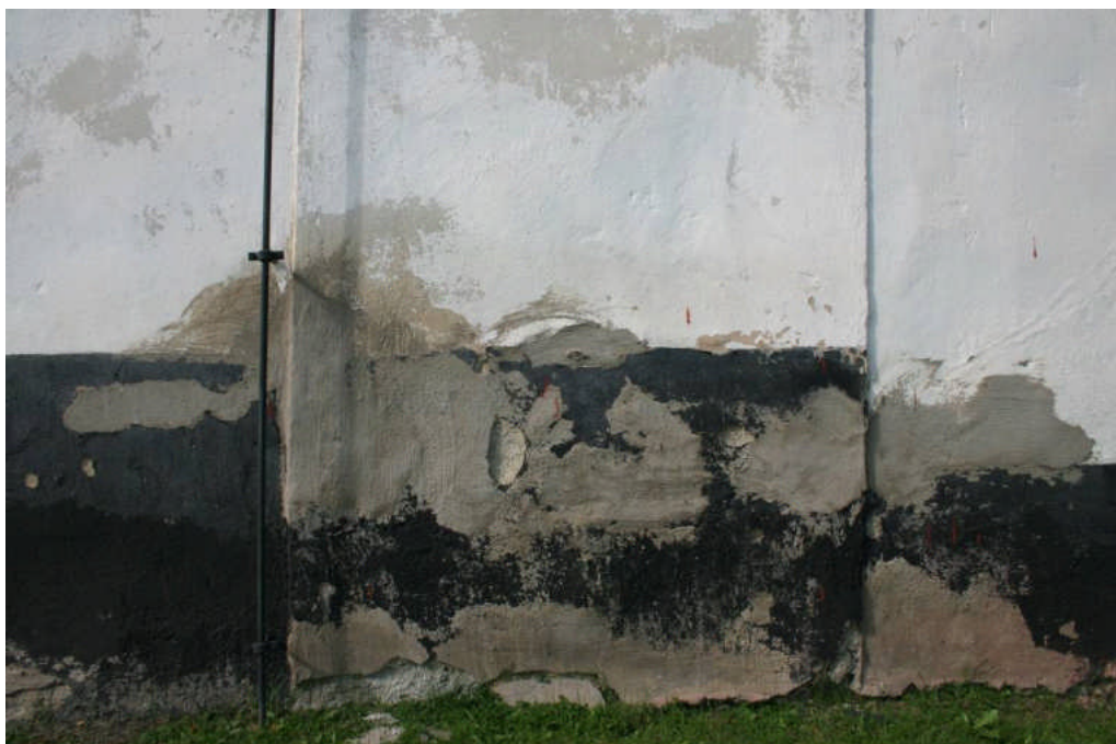
Bild 18. Iagningar som inte har avfärgats på sockeln på östra gaveln, på gränsen mellan långhuset och sakristian. Denna typ av putsilagningar finns runt om på sockeln och även på bogårdsmuren. Foto Christina Persson 2009-09-02
