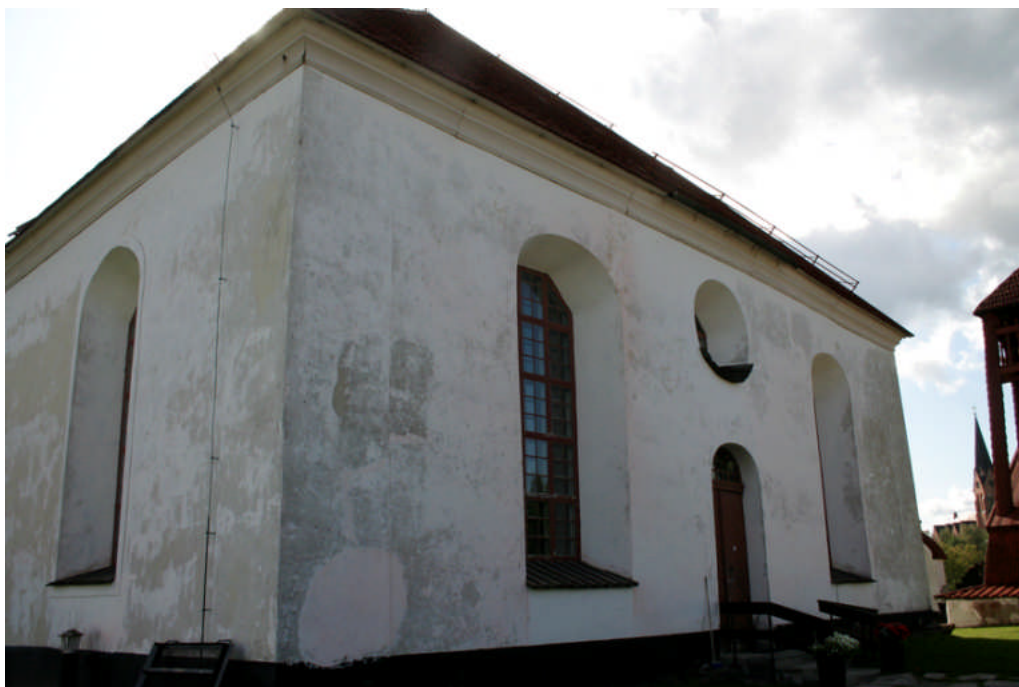
Bild 17. Västra gaveln och delar av norra långhusets fasad vid besiktningen den 2 september 2009. Den yttersta vita kalkfärgen är på vissa partier nästan helt borta. Den rödpigmen terade tjäran från taket har färgat av sig på fasaden. Foto Christina Persson 2009-09-02
