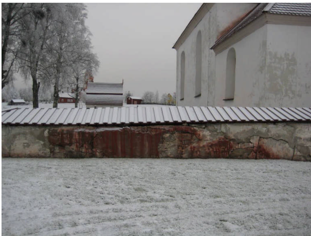
Bild 20. Utsidan av norra bogårdsmuren den 13 november 2009. Murverket kalvar ut och den falurödspigmenterade tjäran har runnit ned på mur och puts. Foto Christina Persson 2009-09-02
