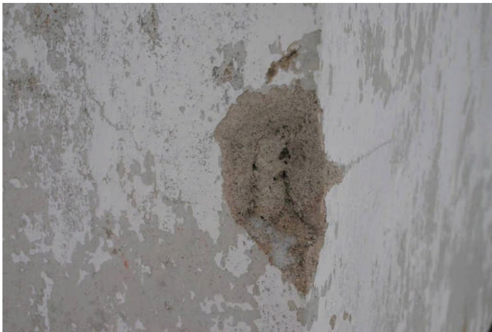
Bild 12. Sakristians nordöstra hörn där putsproverna 5 och 6 togs. På fotot syns den ljusa gråbruna putsen som ligger ytterst, d.v.s. prov 5, och de tre färglagren med vitt, grått och ljusbrunt. Foto Christina Persson 2008-12-03
