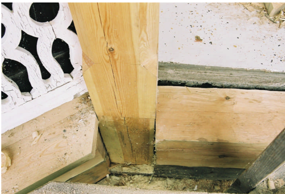
Bild 5. Stolpe 2 ilagades och kubben som stolpen står på byttes ut. Till höger om stolpe 2 syns den utbytta bjälken som ligger ovanpå den nedre syllen. Mellan stolpe 2 och 3 fick både syllen och bottenbjälken bytas eftersom båda var kraftigt rötskadade. Innanför syns det gjutna golvet.
