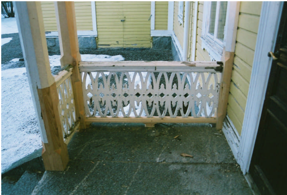
Bild 11. Ilagningar på verandan vid A-väggen. Stolpe 1 är spikad mot A-väggen. Räckesunderliggaren mellan stolpe 1 och 2 är utbytt liksom klossen under räckesunderliggaren (neg nr 07M004/20).
