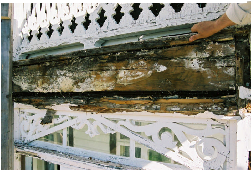
Bild 8. Den bärande yttre bjälken i mellanbjälklaget efter att dekorbrädan avlägsnats mellan stolpe 1 och 2. Bjälken var mycket rötskadad och måste bytas.
