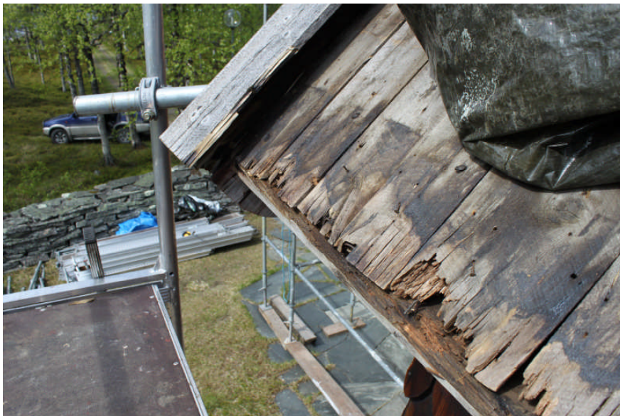
Rötskador på rote, södra takfallet
