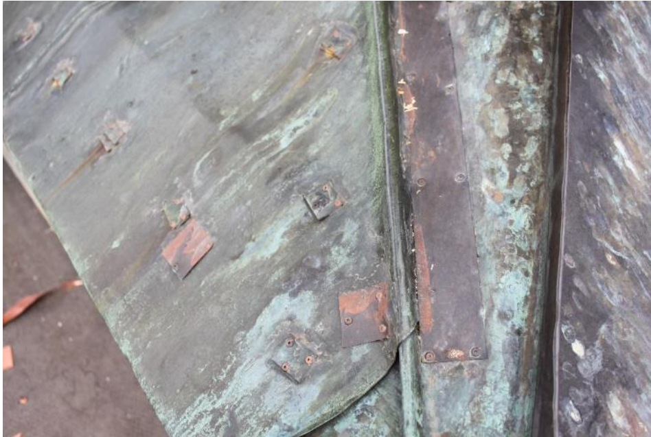
Gamla lagningar på spirans nedre del.
