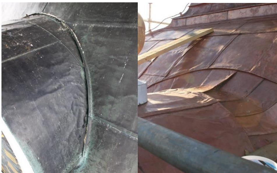
Anslutning mellan kupa och tornhuv före och efter åtgärd.
