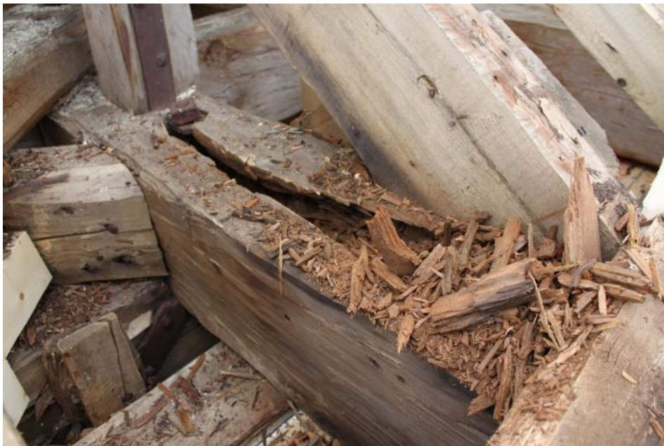
Rötskada i spirans bas.
