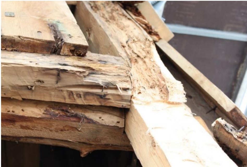
Rötskada i fyrkantsvirke.
