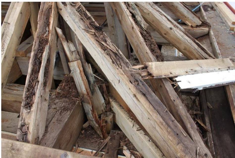
Rötskador i spirans nedre del.
