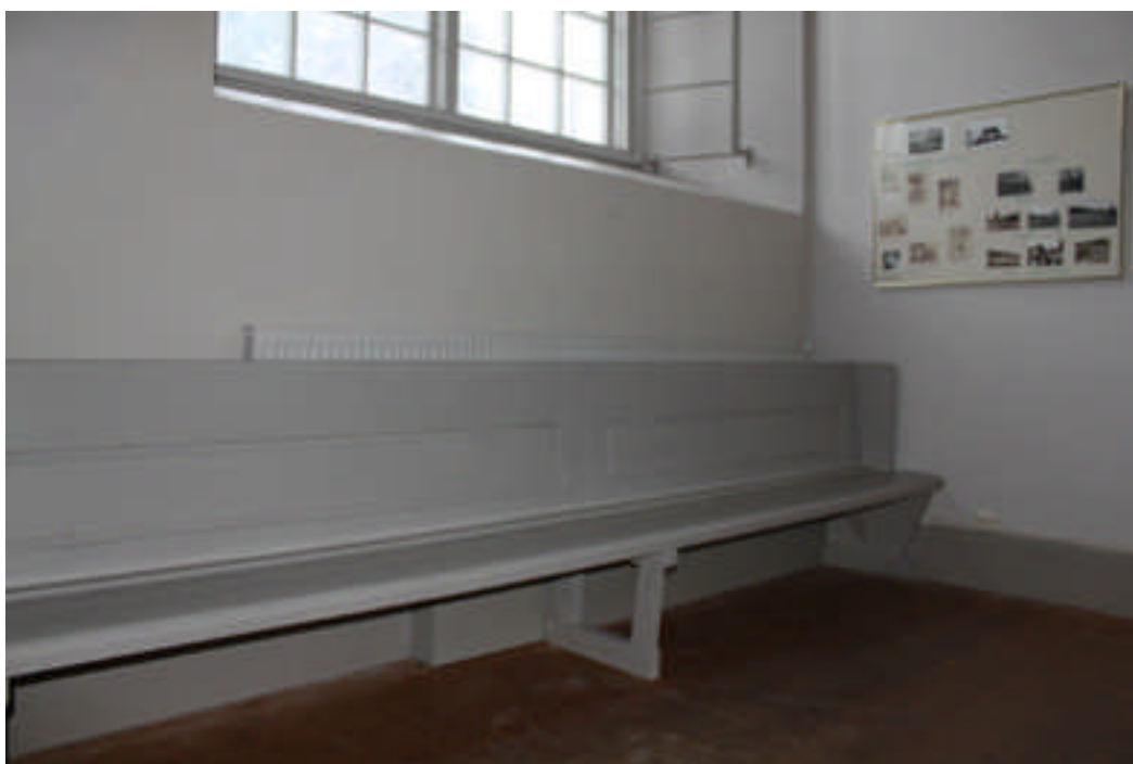
Bild 3: Radiator monterad bakom bänk i kapprum.
