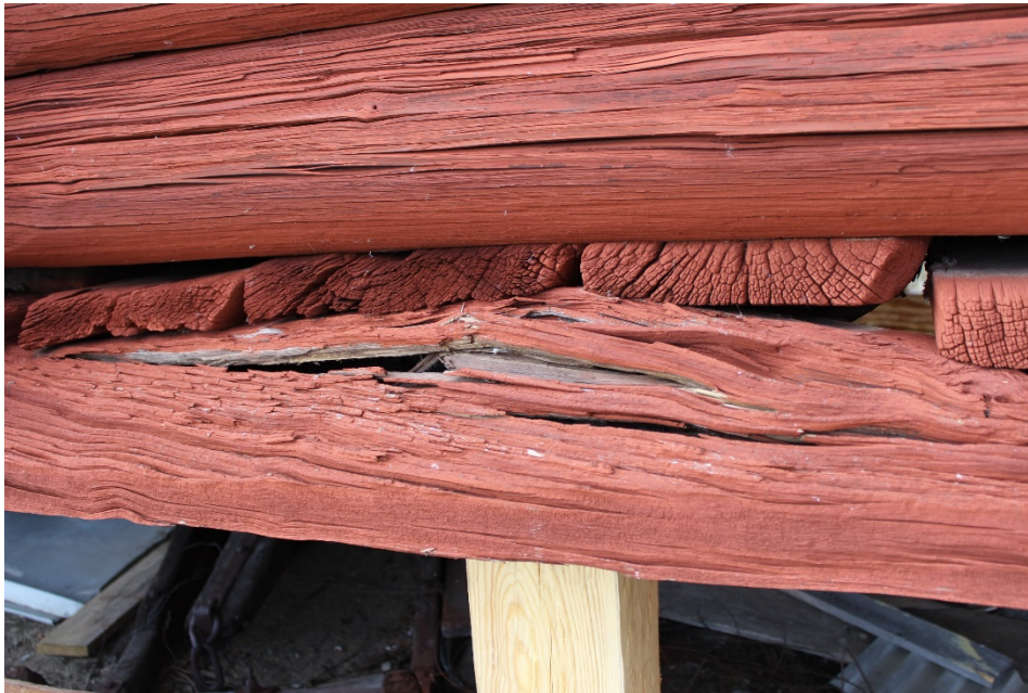
11 Skada på mushylla på C-väggen som uppkommit efter åtgärd.
