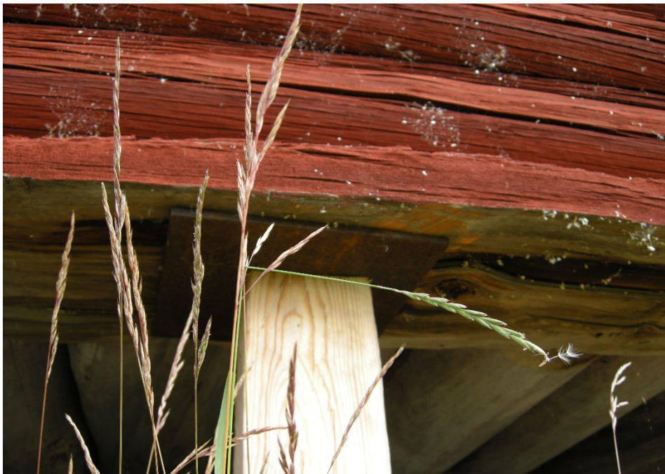
12 Mushyllan sedan den uppkomna skadan åtgärdats 2015. Lägg märke till plåten mellan stolpe och mushylla.
