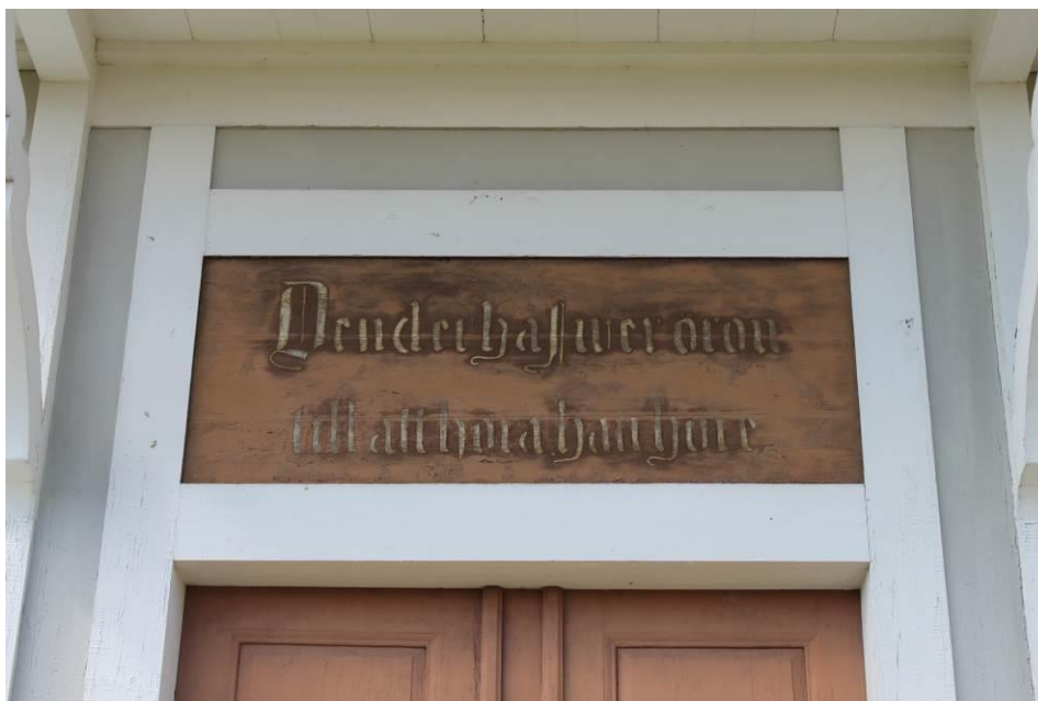
Figur 9 Inskriptionstavla över östra ingången före åtgärd. Lägg märke till den ljus rödbruna tonen på både inskriptionstavla och dörr.
