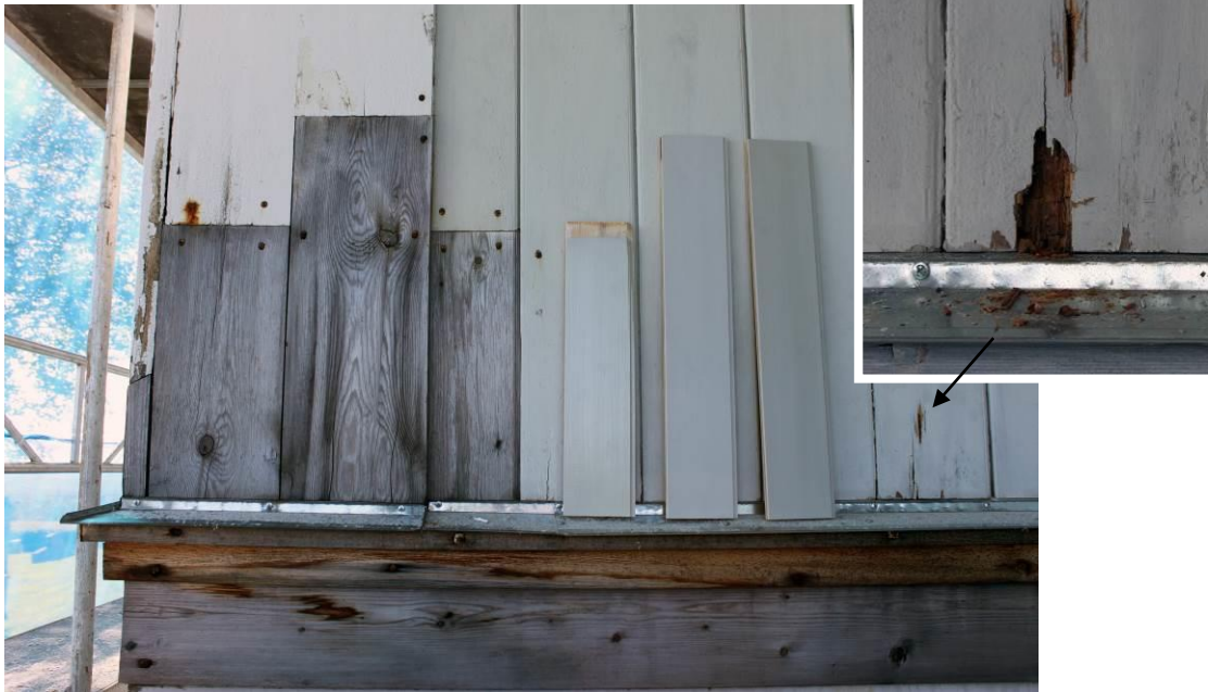
Figur 5 Panelen på långhusets NO-vägg innan åtgärd. Trälagningarna från 2007 stod omålade. Bredvid kulörproverna syns den ena skadan i panelen (se även den infällda bilden). Också intilliggande panelbräda visade sig vara dålig. Observera den omålade plåten.
