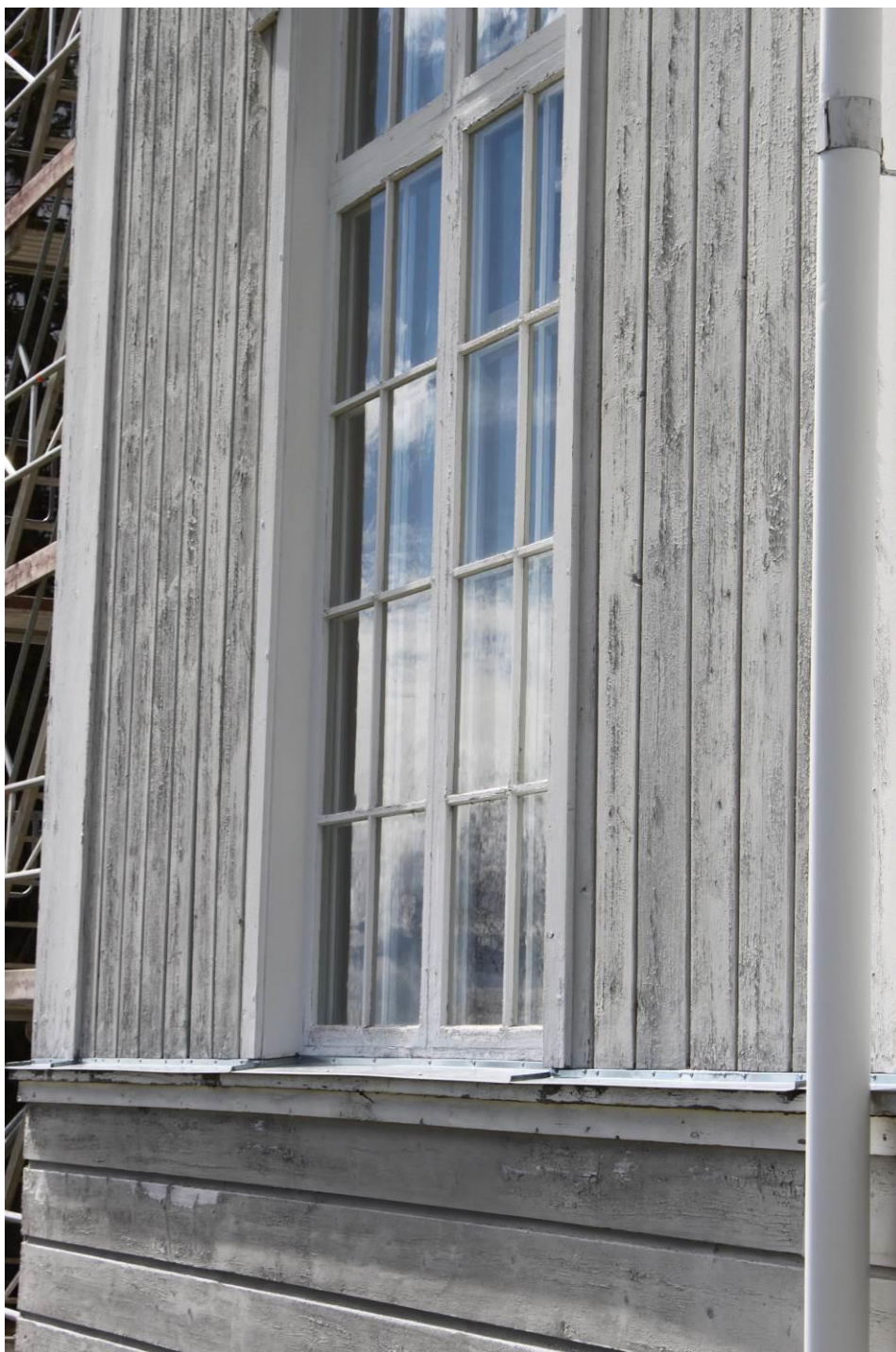
Figur 3 Färgen på fasaden var innan åtgärd torr och spröd. Den grå kulören upplevdes som flammig och fläckig.
