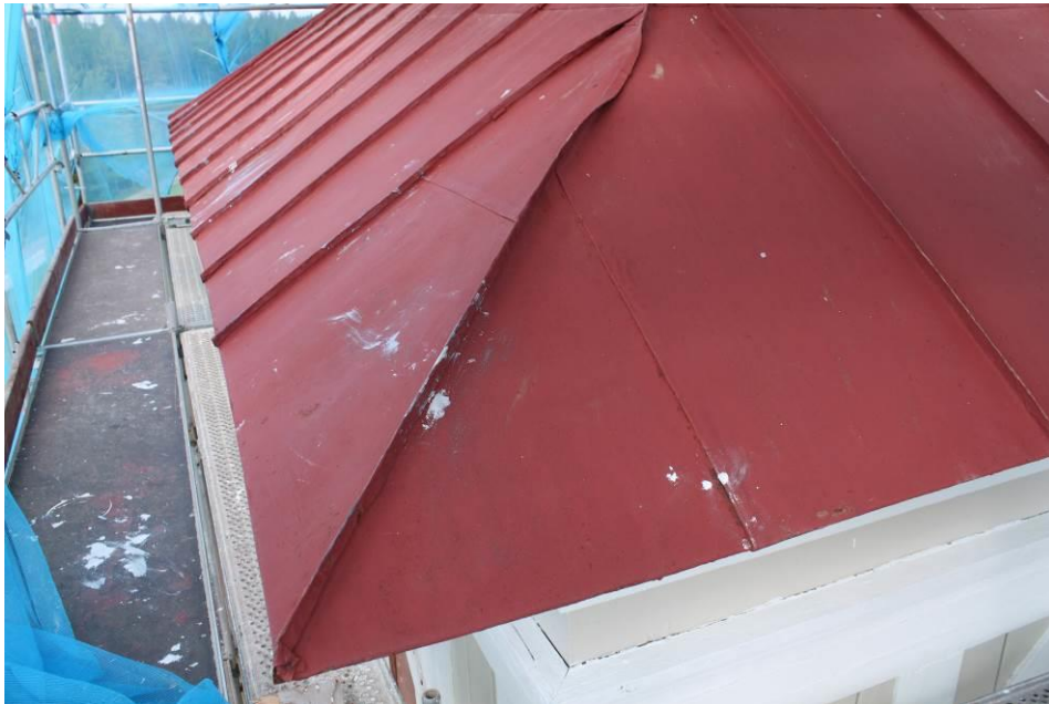
Figur 1 Taket innan ommålning.
