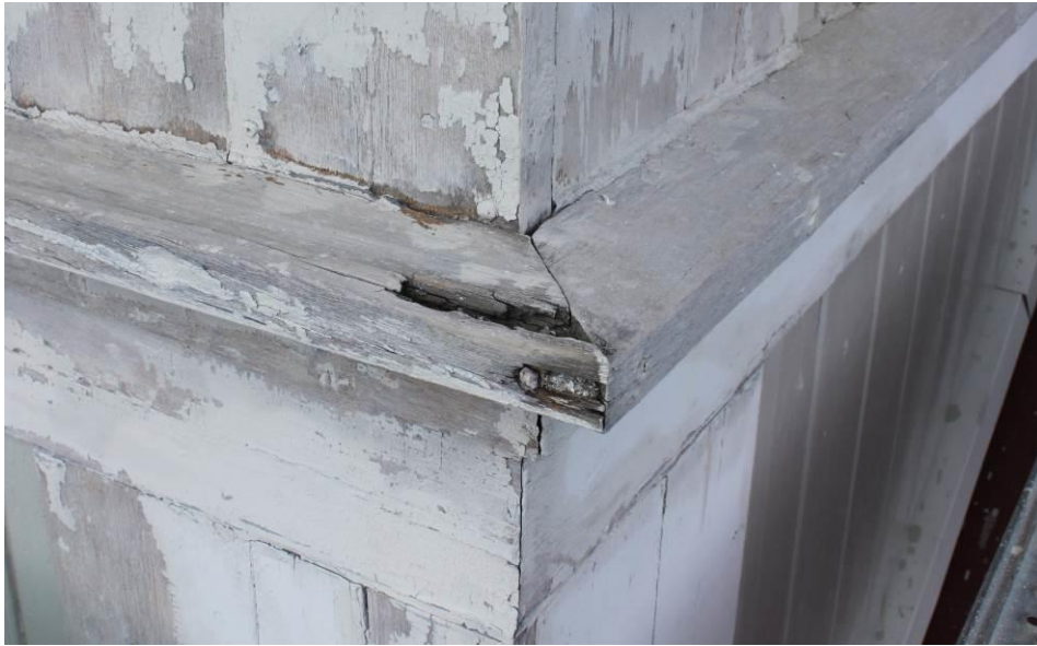
Figur 7 Ej åtgärdad skada på listverk i tornets nordöstra hörn i höjd med ljudluckornas undre kant.
