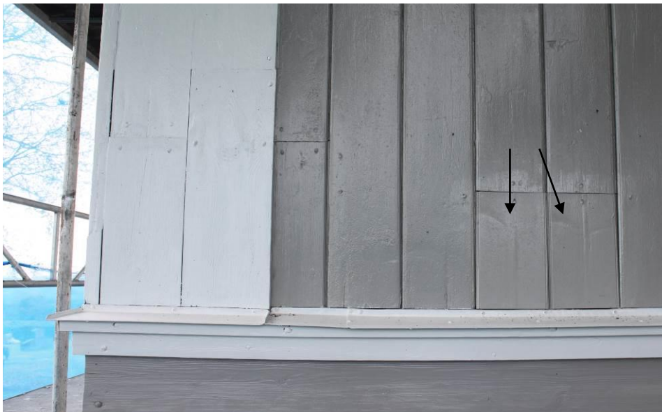
Figur 6 Samma fasad efter lagning och målning. Två av panelbrädorna fick skarvas med nytt virke. Lagningarna har fått samma dimensioner och profilering som den övriga panelen.
