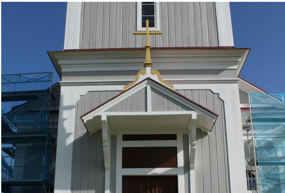
Figur 16 Korsen över entrétaken fick vid ommålning samma kulör som kors, korsglob och övriga dekorelement.
