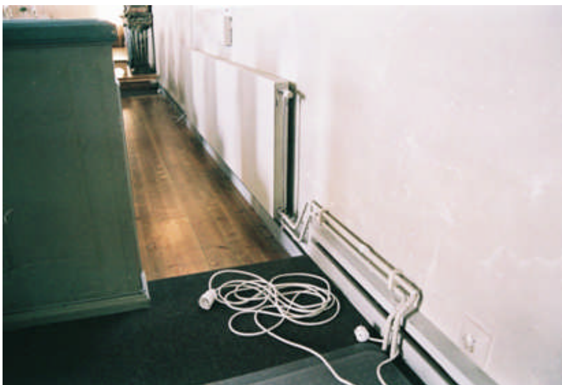
Bild 5: Radiatorema och kondensuppsamlarna under fönstren i långhuset.
