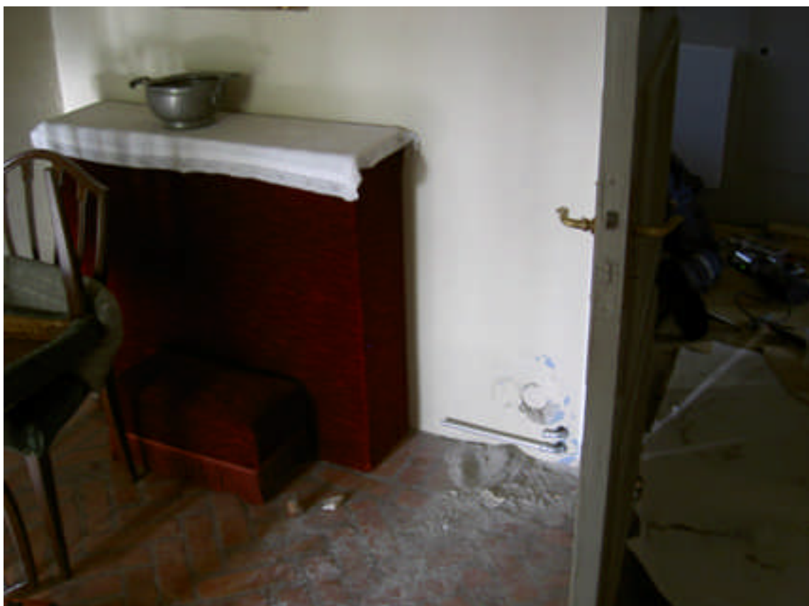
Bild 6: Ledningar indragna till sakristian.
