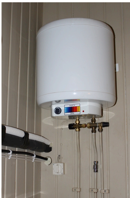
Ledningarna kommer in under varmvattenberedaren i vapenhusets toalett.
