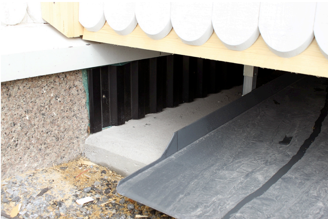
Detaljbild av påbyggnadens nedre del mot tornet. En Trp-plåt har lagts mot kyrkans sockel för att eventuell svallis som kan bildas vintertid inte ska ligga mot sockeln. Plåten på betongplattan är avsedd att fånga upp och leda ut det kondensvatten som kontinuerligt bildas.
