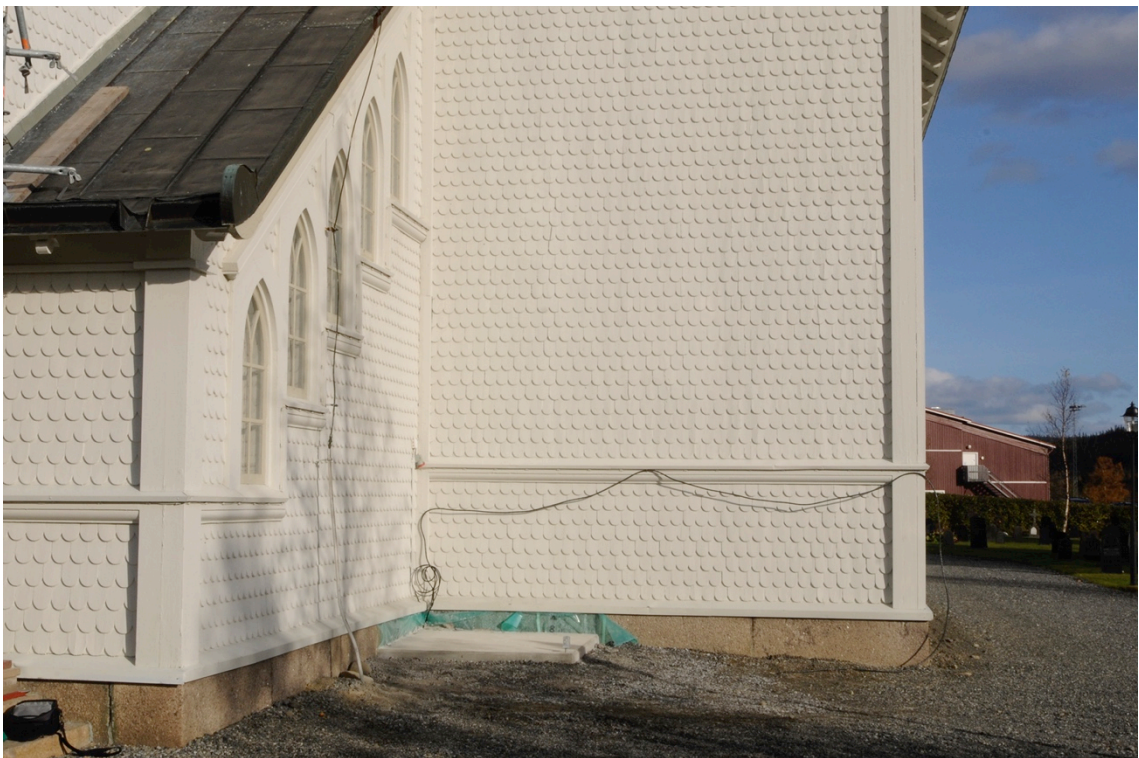
Kyrkans södra fasad i hörnet mellan torn och långhus när enbart grundplattan var gjuten.
