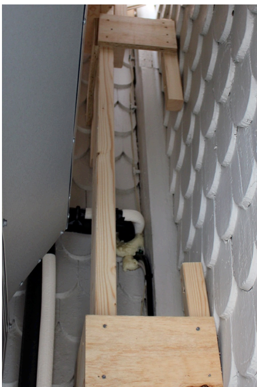
Längst in i hörnet mellan torn och långhus går ledningarna in i tornet.
