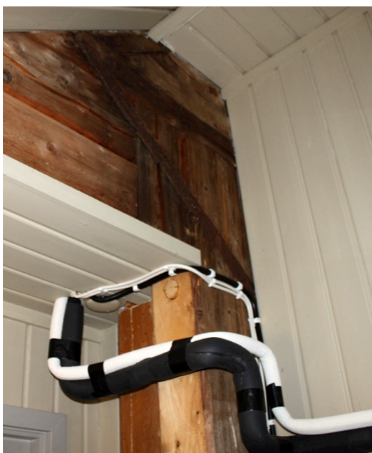
Från toaletten följer ledningarna det befintliga avluftningsröret under södra trappan och upp på tornets andra våning.
