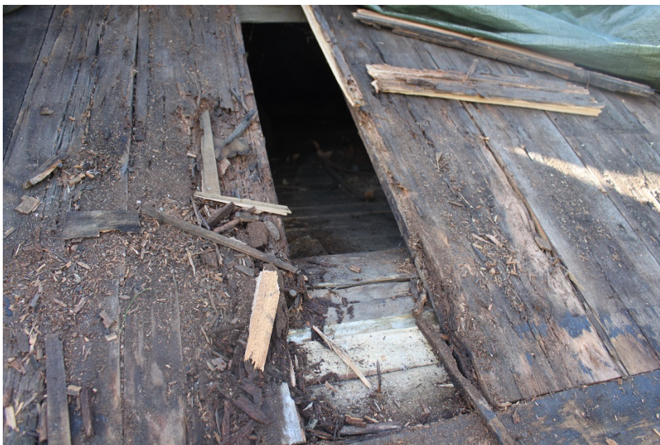
Figur 10 Under spåntäckningen var rotet rötskadat.
