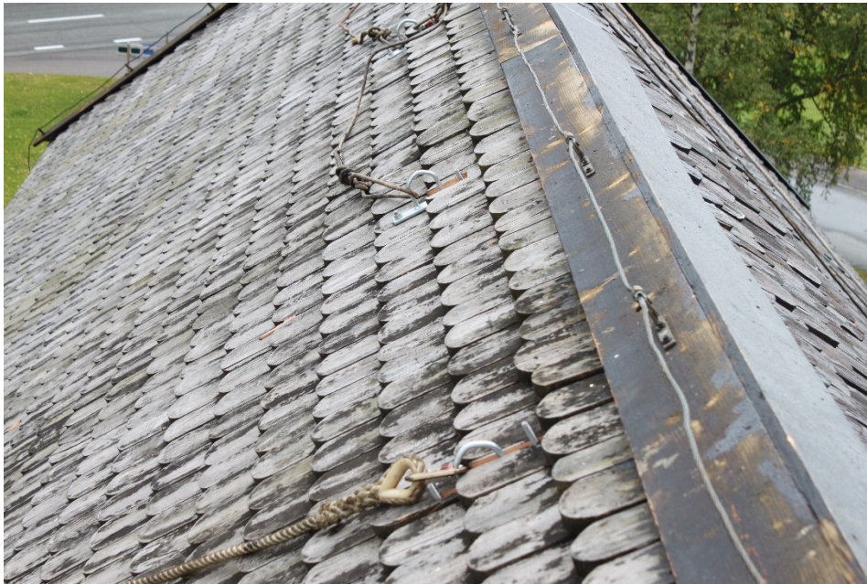
Figur 5 På det norra takfallet har man monterat 5 taksäkringar i form av öglor för infästning av rep.
