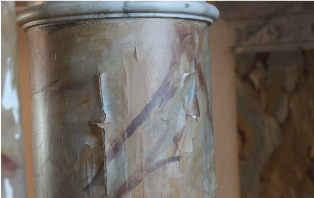
Färgen hade släppt i större sjok på kolonnerna ute i vapenhuset.
