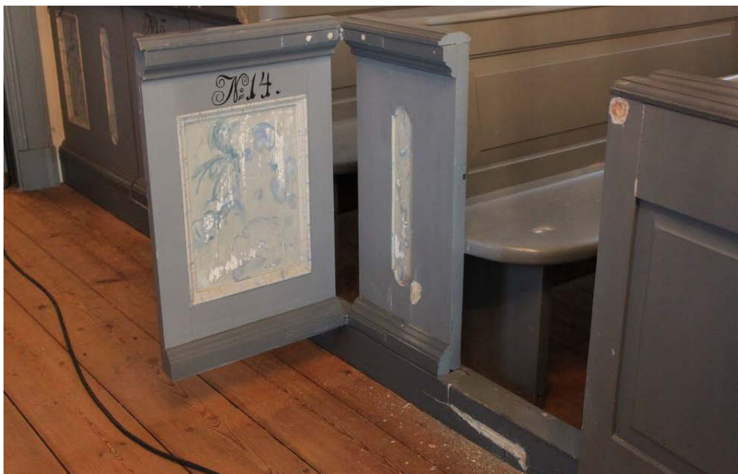
Skador i färgskikt på bänkskärmar och dörrar.
