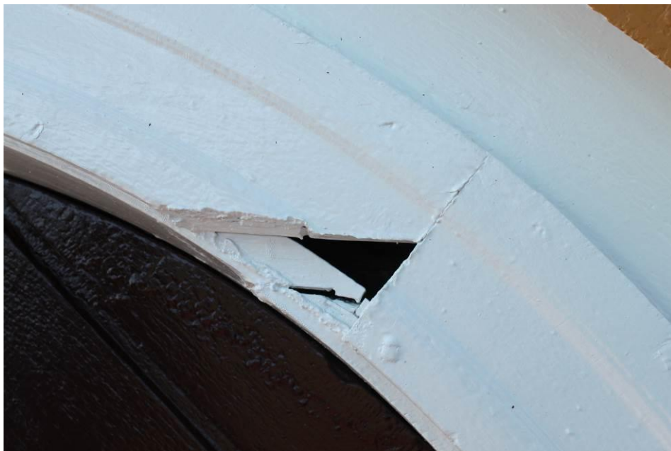
Figur 3 Uppe på tornet upptäcktes ett avslaget hörn på omfattningen till den östra ljudluckan.
