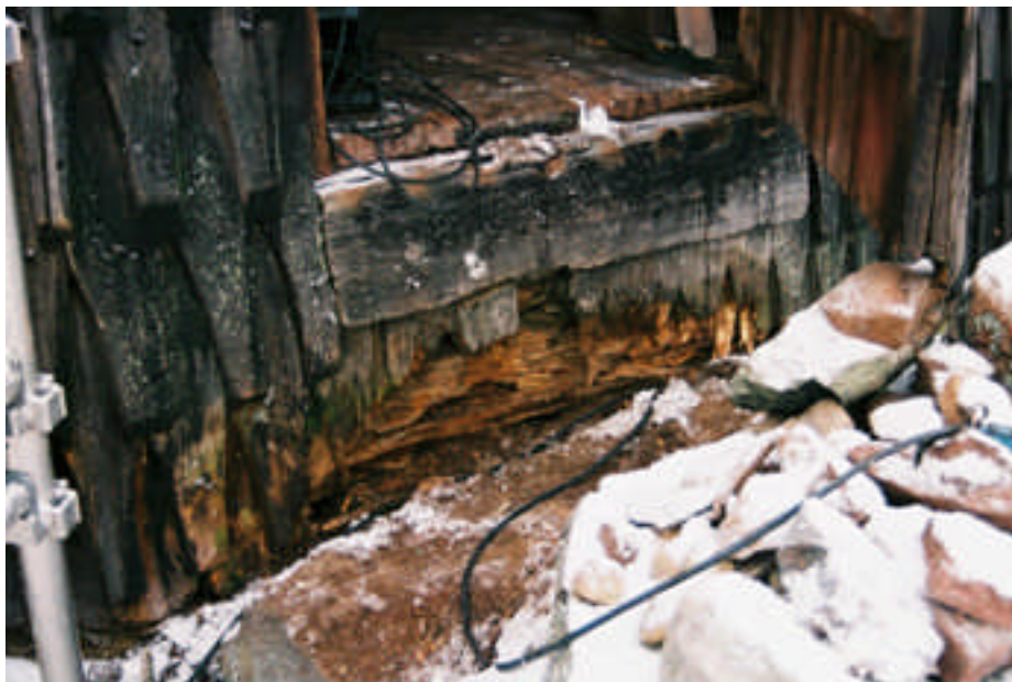
Bild 2. Skador i syll och på spån vid dörr, innan åtgärd (bild nr 08m51/20).
