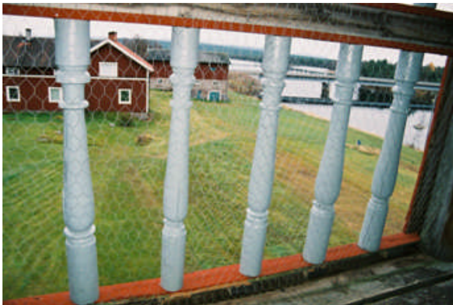
Den tredje dockan från vänster är utbytt. På bilden syns även hur balusterdockornas detaljutformning skiljer sig åt (bild nr 09m037/23).
