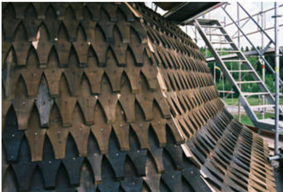
En stor del av karnistakets spån åt söder har bytts ut (bild nr 09m015/34).
