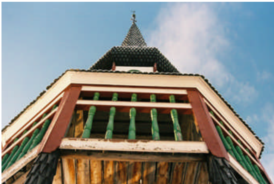
Klockstapelns färg flagnad kraftigt innan restaureringen (bild nr 08m057/37).
