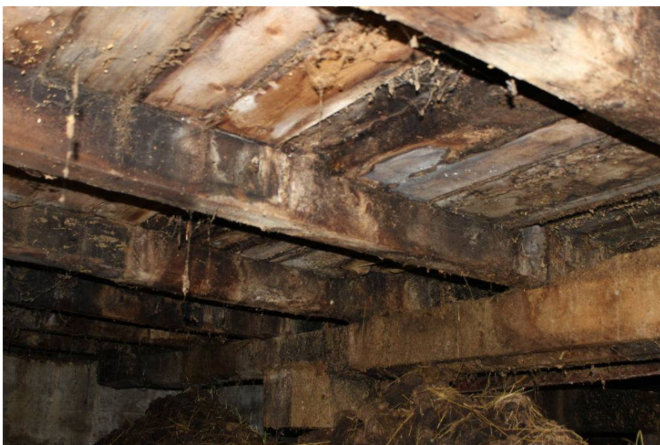
27. Rötskador under fjösets golv.
