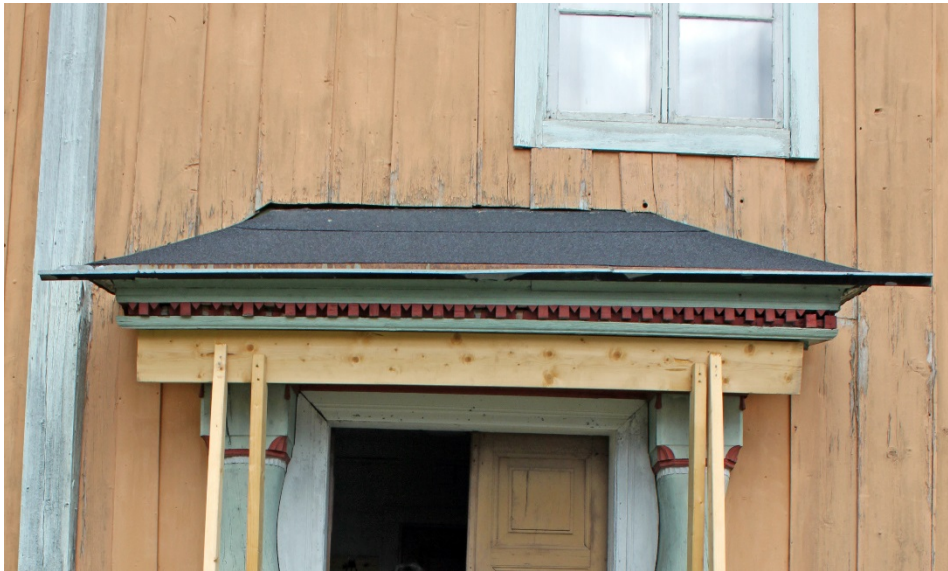
Figur 10 Krön före åtgärd.
