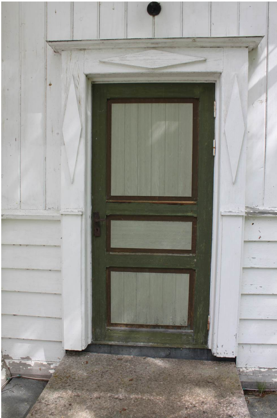
Figur 5 Dörr till sakristian före åtgärd.
