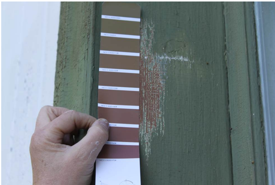
Figur 7 Fönster före åtgärd. På bilden matchas den underliggande bruna kulören mot NCS (NCS S 5020-Y50R).
