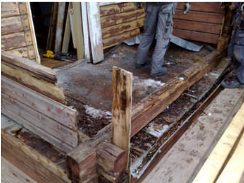
Stora rötskador fanns i hela balkongen (foto Bertil Andersson 200904211030).
