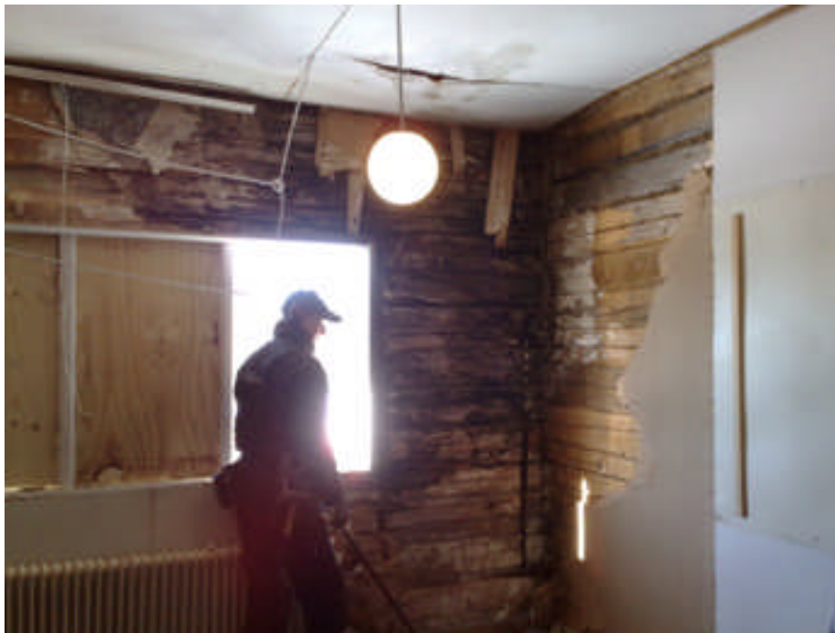
Väggen och taket i skolsalen var mycket rötskadade (foto Bertil Andersson 20090319808).
