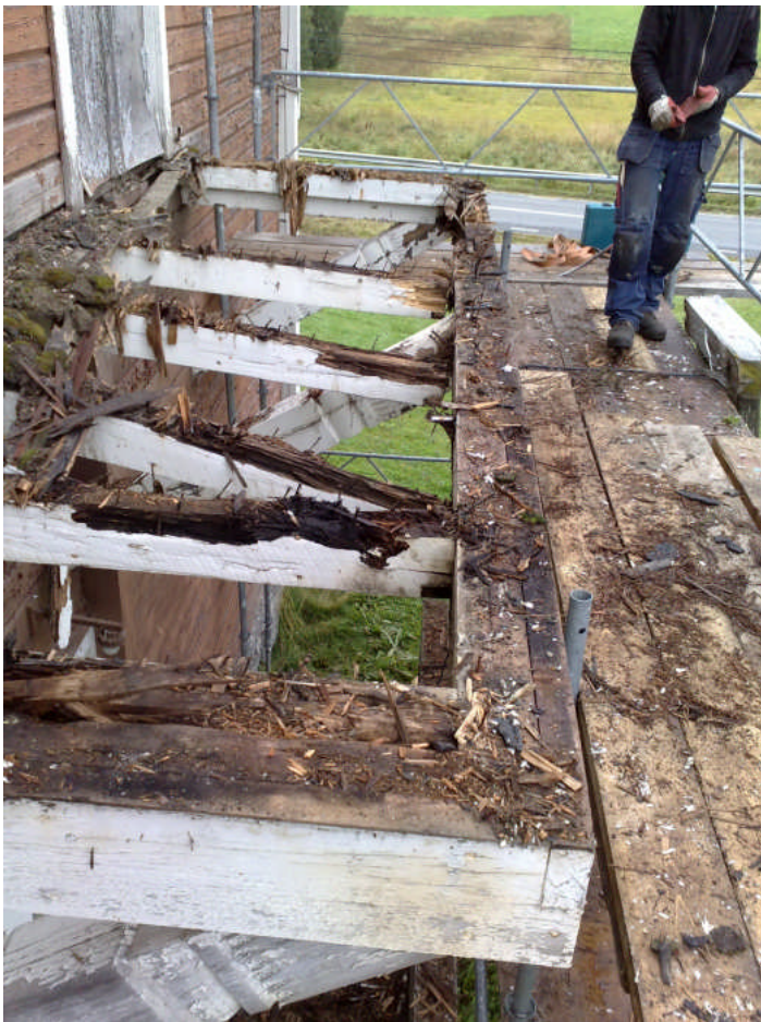
Den västra balkongen hade stora rötskador (foto Bertil Andersson 20080902079).
