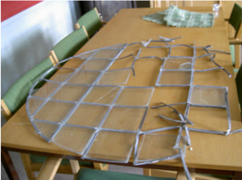
Glas och blyspröjs i korfönstrets ytterbåge var mycket trasigt (digital bild nr 080813 003).
